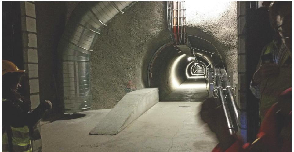
Electrical Conduit Tunnel
